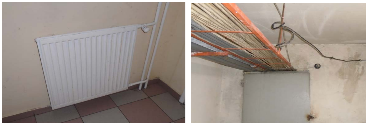
Фиг. 21. Отоплителна инсталация
