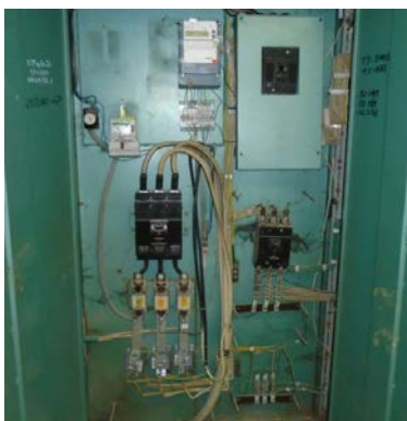
фиг. 23. Захранване на сградата и електромер
