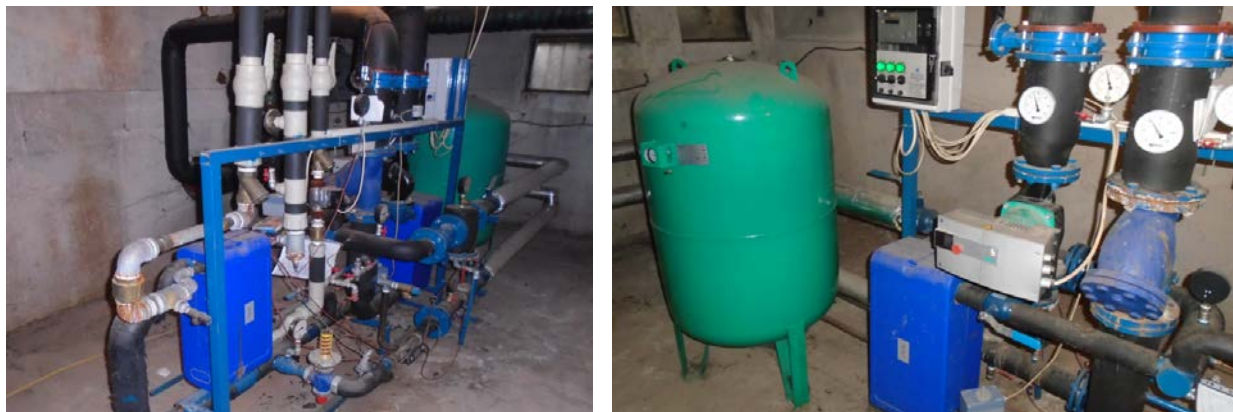
Фиг. 20. Абонатна станция
